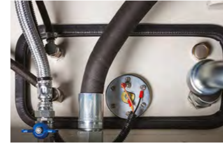
Depósito de combustible
